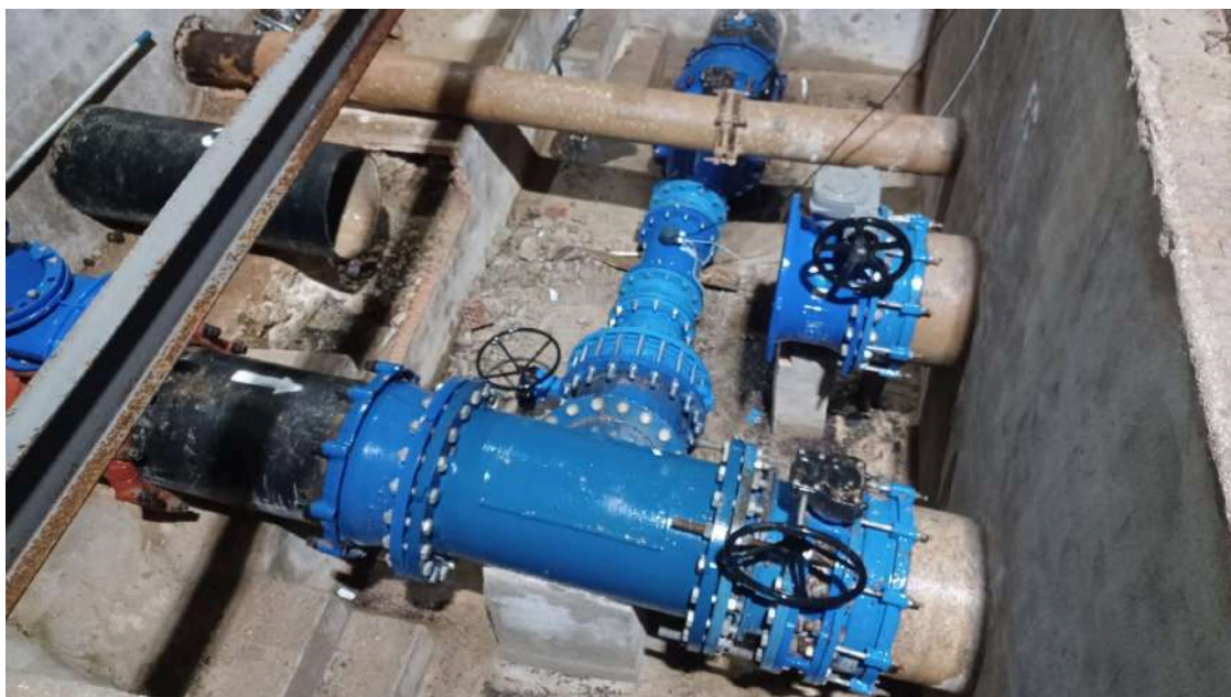
El nuevo caudalímetro general instalado en Valdepeñas / Ayuntamiento de Valdepeñas
