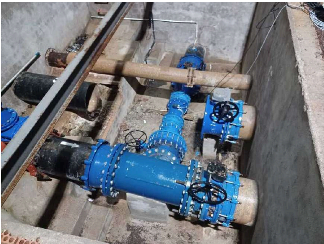
Valdepeñas instala el nuevo caudalímetro general
